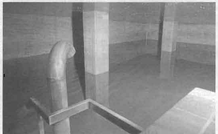
Im Wasserbehälter Leimberg sieht man 2 Becken mit je 200.000 Litern Wasser.
